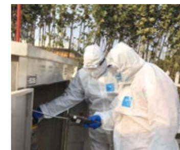
淄博公司开展燃气管道巡检
