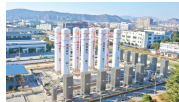
苏州公司 LNG 应急调峰站
